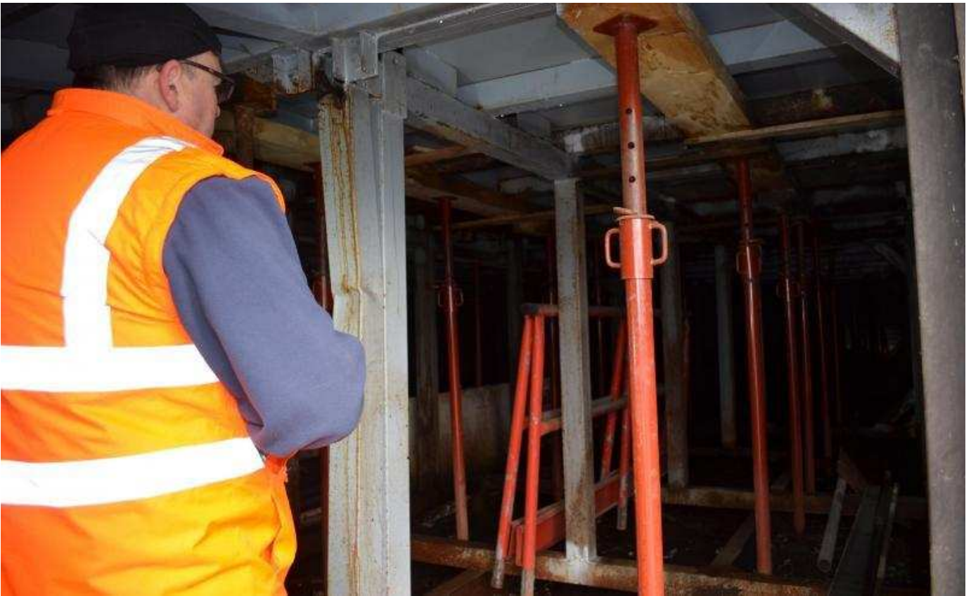
Les piliers qui soutiennent les quais modulaires de la déchetterie de Merville sont vacillants. Photo archives LA VOIX.
